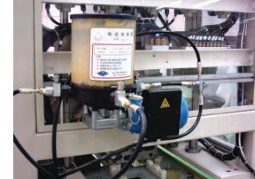
自动加油泵 Automatic lubricating pump
